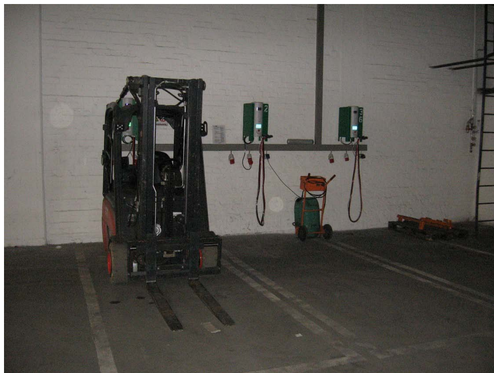
Foto 10: Gabelstapler Ladestation (Halle 4)
