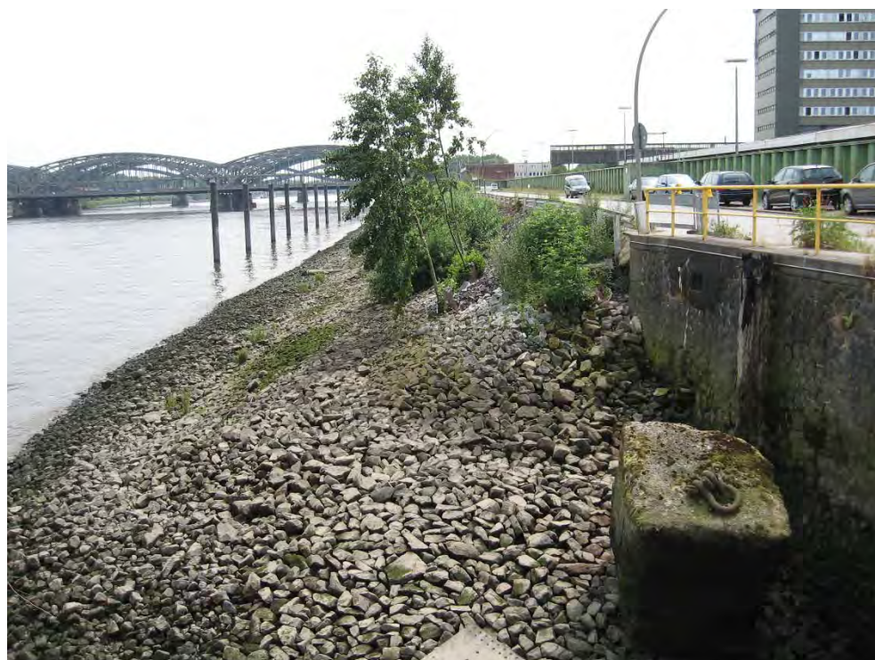
Foto 25: Uferböschung an Holthusen kai (Blickrichtung Ost)
