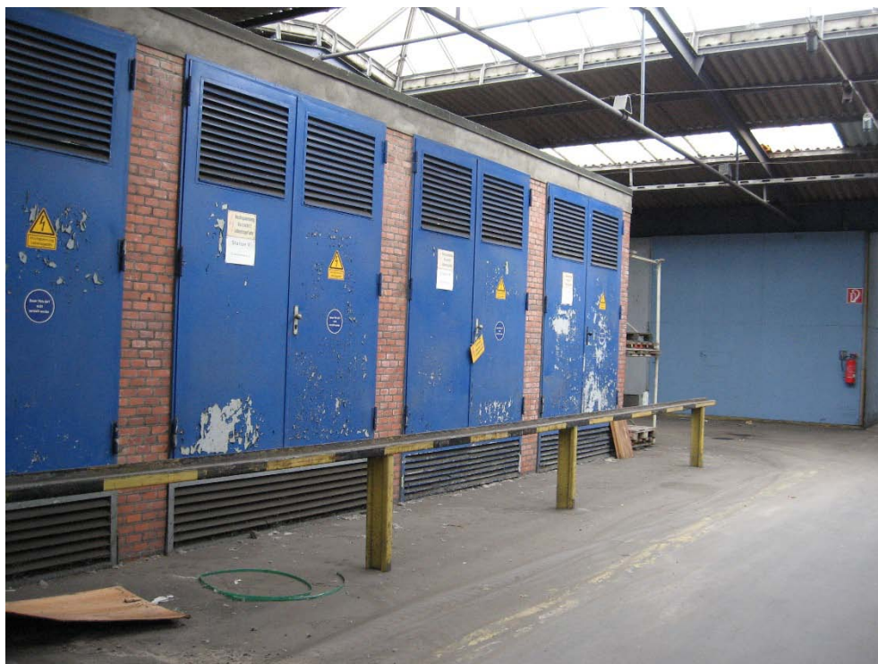
Foto 6: Trafostation östlich Halle A10
