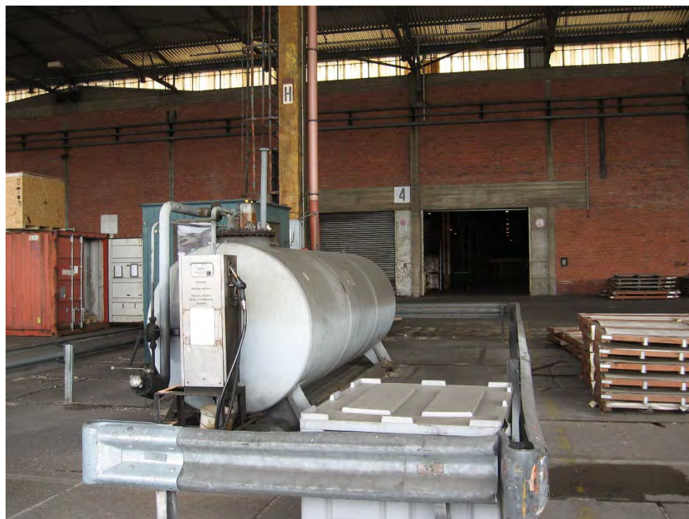
Foto 21: Eigenverbrauchstankstelle östlich des Hallenkomplexes
