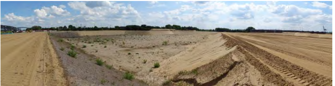
Abbildung 3: Sandauflagen im Bereich des ehemaligen Überseezentrums im Juni 2025
