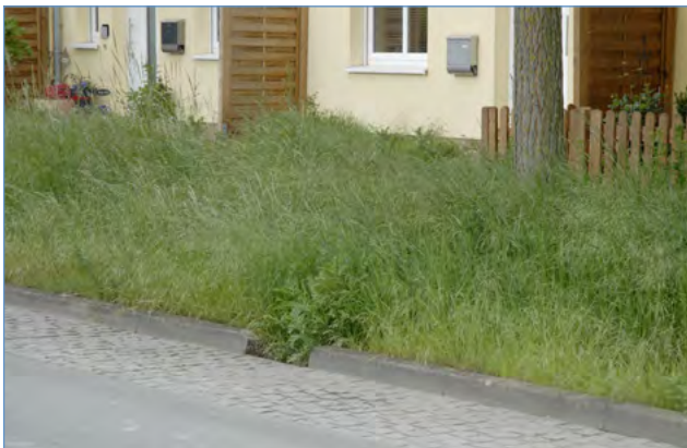
Abb. 25: Straßenentwässerung in bepflanzte Versickerungsmulde
