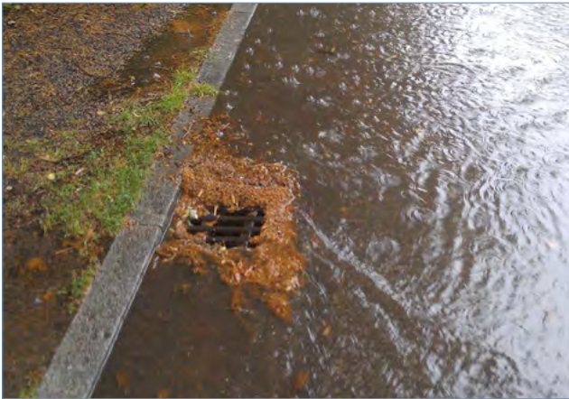
Abb. 6: Überflutung als Folge verstopfter Trummen
