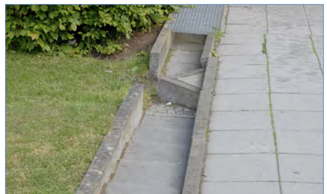
Abb. 10: Entwässerung über eine offene Kastenrinne
